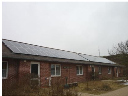
Die Solarmodule auf dem Haus 4
